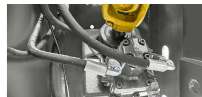
To oliepumper forsyner det indgående gear og knytterrensningssystemet TURBO FAN med hydraulikolie.
